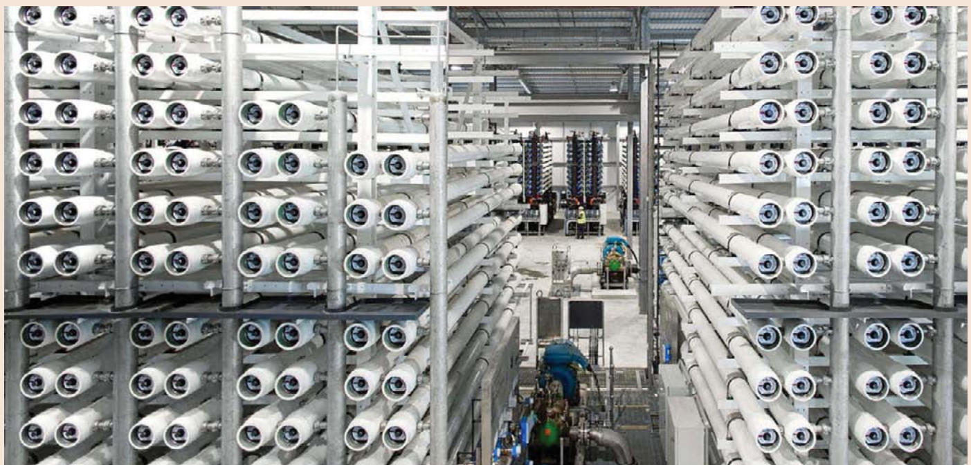
DESALINIZACIÓN La compañía Acciona inauguró en 2010 la primera planta de desalinización de Gran Bretaña (en Beckton, Londres), impulsada tanto por el crecimiento de la población como por la escasez de recursos naturales en la zona. Es la primera planta desalinizadora que extrae agua del estuario del río Támesis usando la técnica de membranas de ósmosis inversa, y cada día abastece a 900.000 personas. Fue galardonado en 2009 como el proyecto más sostenible del año por la revista 'Global Water Intelligence' y en el 2011 como Mejor Planta Desaladora.
