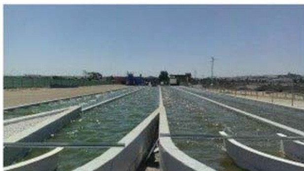
Estación depuradora de aguas residuales (EDAR)
